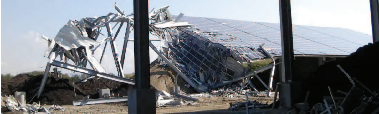
Abbildung 2: Eine der mehrfach thermografierten Anlagen, aus einem Sturmschadens-Gutachten. Die vorab leicht erkennbaren Modulschäden bleiben in der Studie unberücksichtigt.
